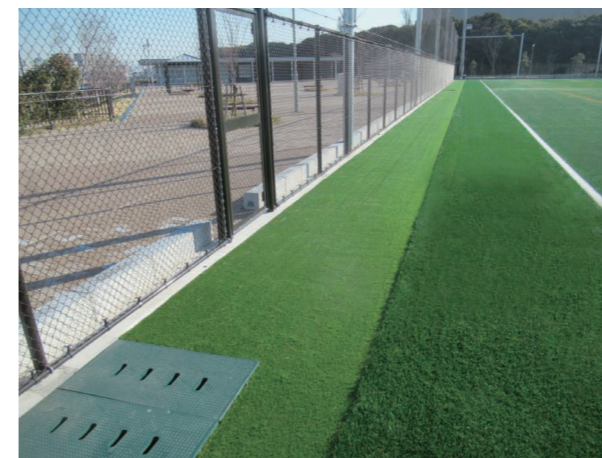
雨水溝上にフィルター材として透水性人工芝を設置するとともに外周をブロックで囲うことで風による飛散を抑制
