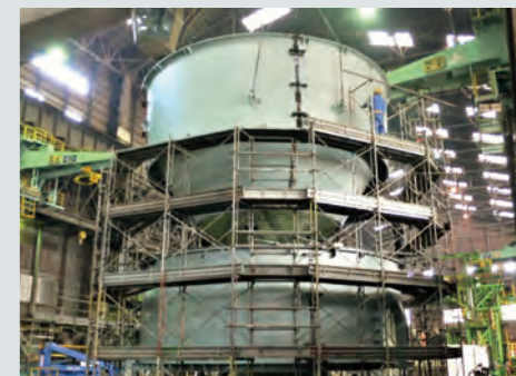
産業用溶接構造物
