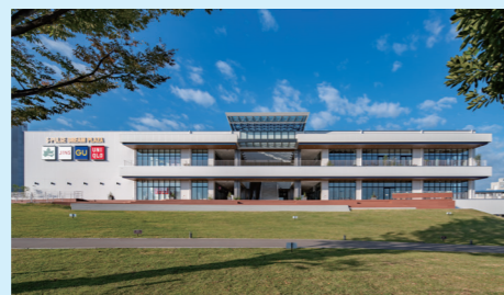
静岡県清水市 エスパルスドリーム プラザ 新館 機械設備工事一式(給排水衛生設備・ 空気調和設備・換気設備・消火設備・ガス設備)
