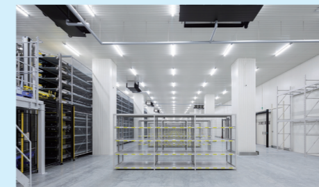
神奈川県 厚木市 ORD厚木冷凍ステーション 冷凍冷蔵設備
