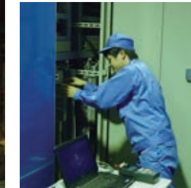
発電所内の機器メンテナンス
