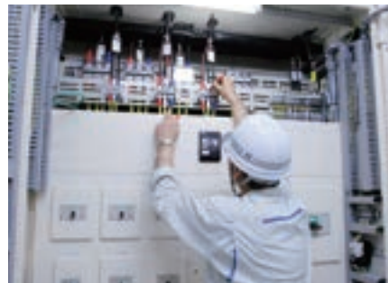
送電前の確認
