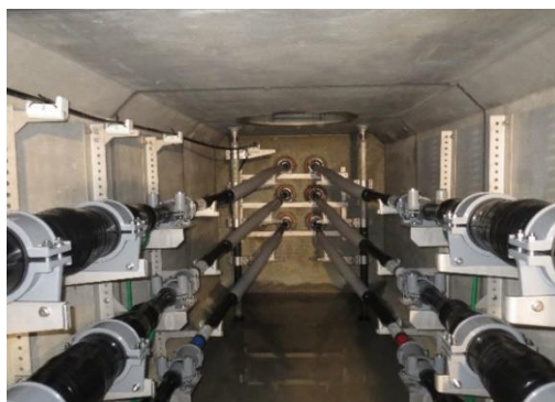
洞道内ケーブル
