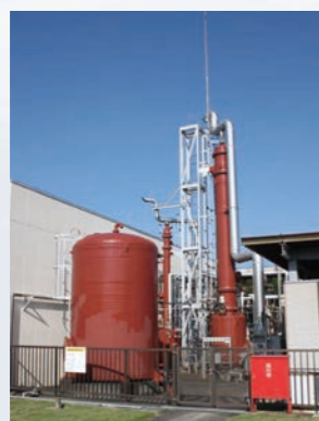
大量脱酸処理施設
