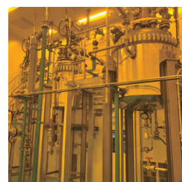
クリーンルーム内観
