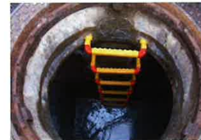
エポ工法・ツインドリル工法 テレビカメラ調査・排水管清掃
