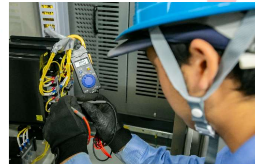
機械・電気設備 管理保全
