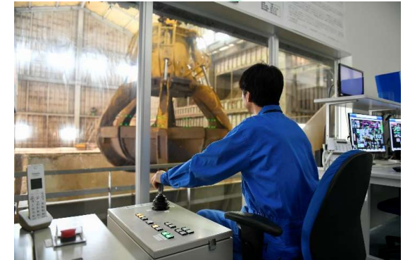
バイオマス発電 中央制御室
