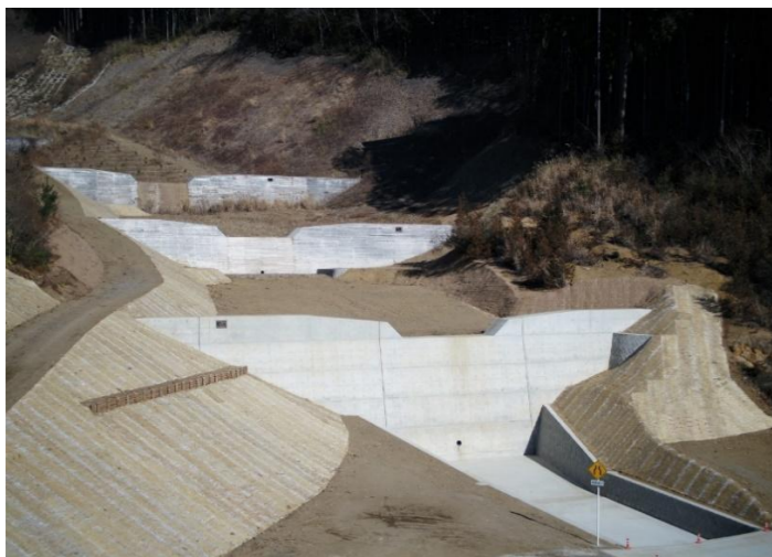
■令和4年度(補正)復旧治山事業外谷止工外工事【栃木県日光市】
