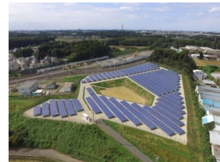
■ 東武高柳太陽光発電所836KW
