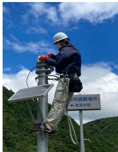
雨量計の点検
