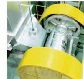
⑧ 破碎設備
