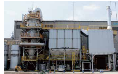
⑨ 排ガス処理設備
