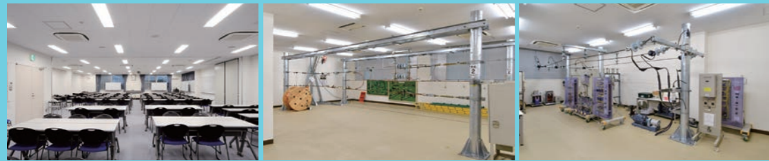
研修室 電車線設備 電灯電力設備
