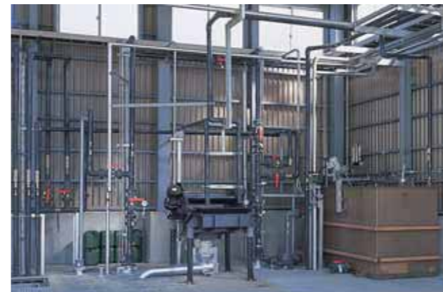
廃酸・廃アルカリの中和施設
