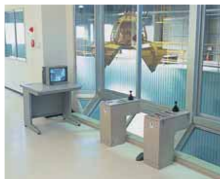
供給クレーン操作設備
