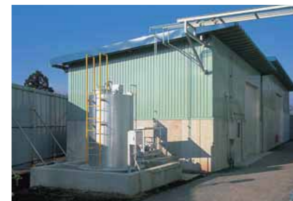
オイル回収棟
