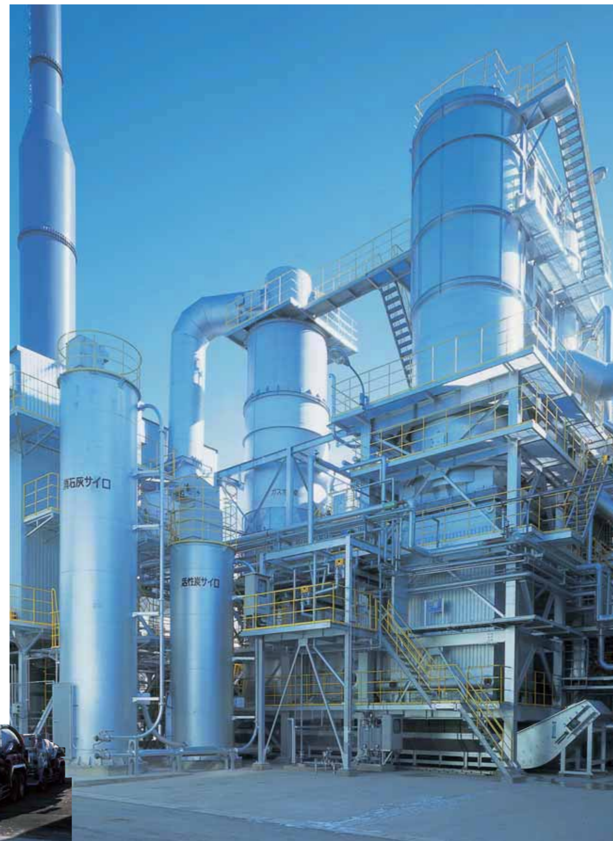
二次燃焼炉とガス冷却室
