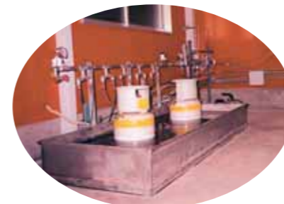
ポンベ加熱水槽と高圧サービスタンク
