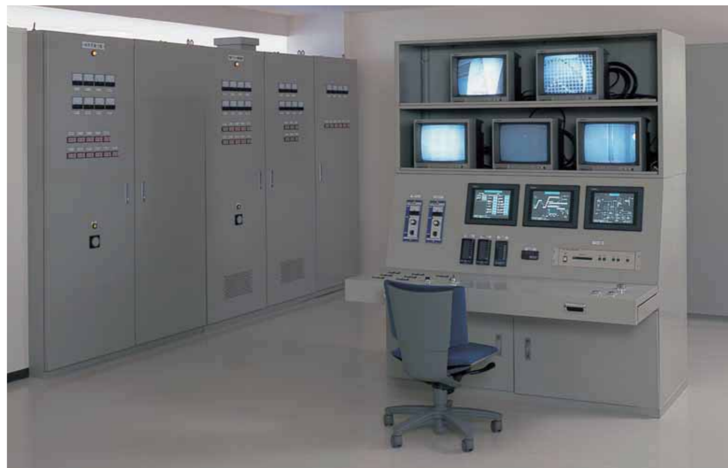
マテリアルリサイクル施設制御室
