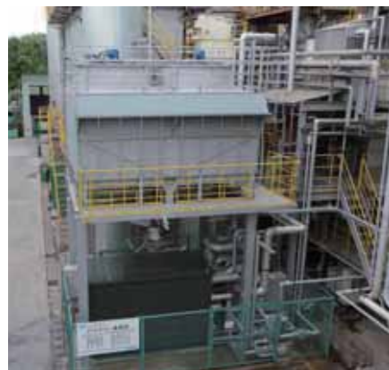
バイナリー発電設備 (125 kW)
