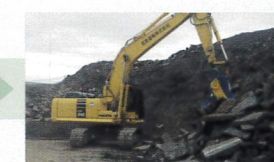
アスファルト合材工場内に集積
