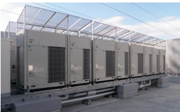
エアコン室外機
