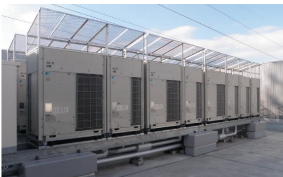
エアコン室外機
