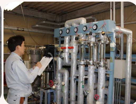
浄水場の圧力点検
