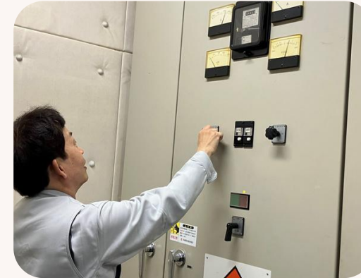
配電盤の点検
