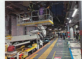
渋谷駅プロジェクト 電車線工事 施工場所: 東京都 発注者: 東日本旅客鉄道株式会社
