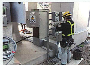
我孫子駅 電源新設工事(ATC) 施工場所：千葉県 発注者：東日本旅客鉄道株式会社
