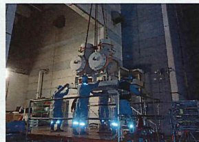
新宿交流変電所 電気設備新設工事 施工場所：東京都 発注者：東日本旅客鉄道株式会社
