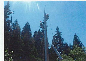
奥羽本線 デジタル無線工事 施工場所：山形県 発注者：東日本旅客鉄道株式会社
