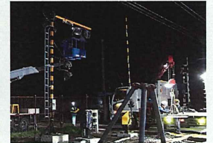
成田線小見川駅 踏切拡幅に伴う踏切保安装置改良工事 施工場所: 千葉県 発注者: 東日本旅客鉄道株式会社
