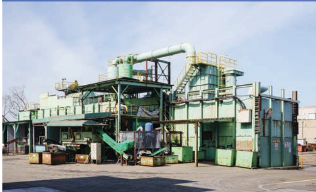
再資源化プラント
