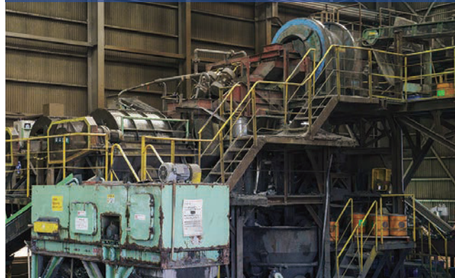
非鉄選別プラント(アルミ重液選別装置)
