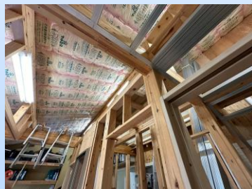
天井裏断熱材
