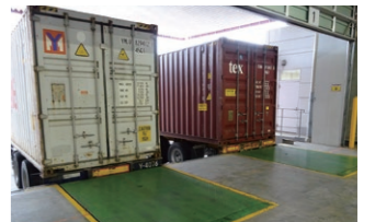
段差を調整するドックレベラー
