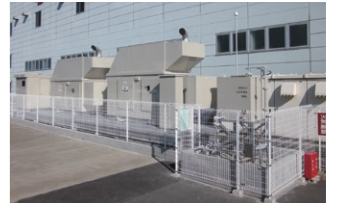
電力を安定供給する非常用発電機
