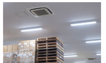
品質と快適な環境を守る空調設備
