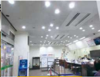
冷暖房・換気装置
