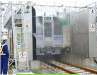
車両洗浄装置
