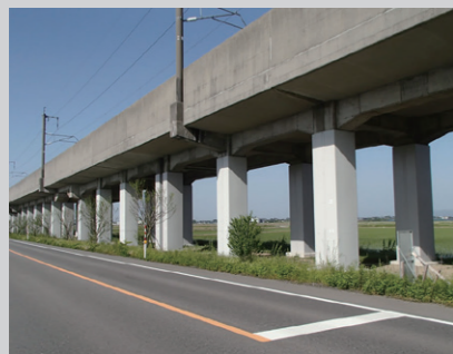
上越新幹線燕三条新潟間家立裏高架橋 ほか14高架橋耐震補強
