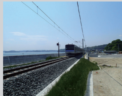
東北地方太平洋沖地震に伴う災害復旧 (仙石線軌道敷設西工区)
