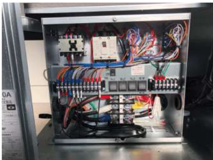
冷凍機設備 制御回路盤
