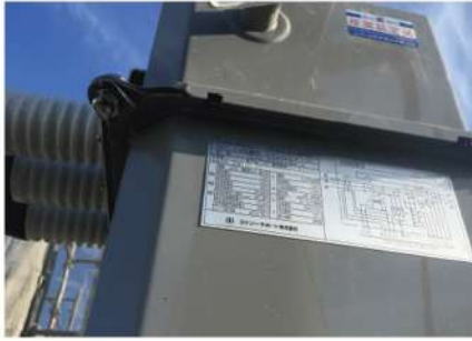
高圧開閉器設置管
