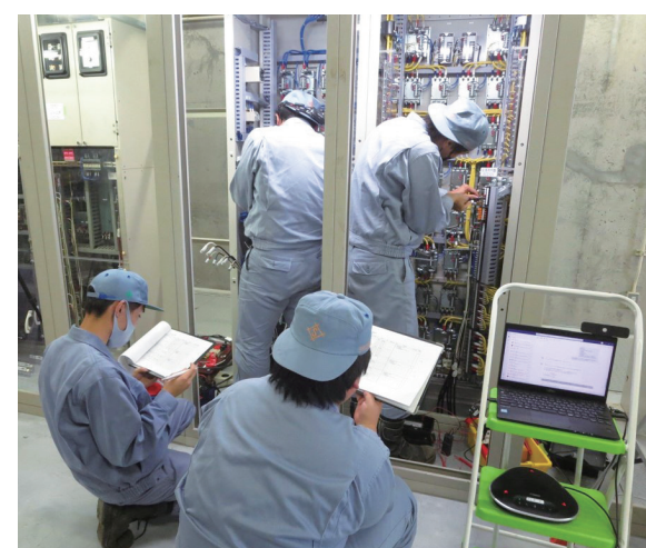
各種ケーブルを引き込み、端末処理や機器接続作業を行います。配線する順番や配線方法など十分な知識と技術を用いて作業を行います。
