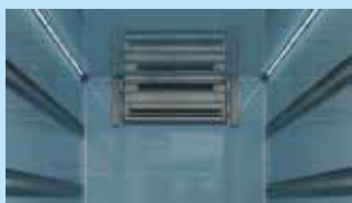
荷室内の空調機
