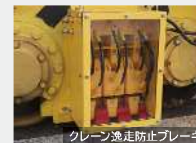
クレーン逃走防止ブレーキ
