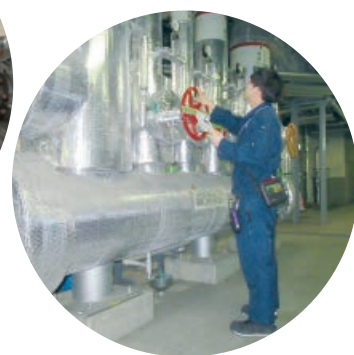
蒸気ヘッド圧力点検
