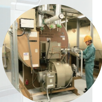
温水ボイラー点検
