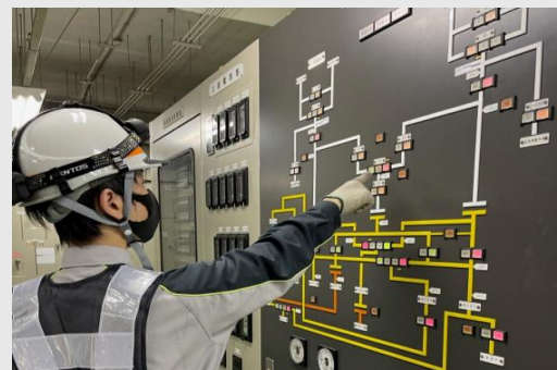
【駅電気室設備】
