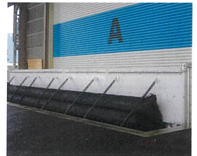
止水板・防水扉
