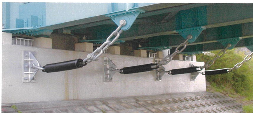
落橋防止システム (緩衝チェーン)
