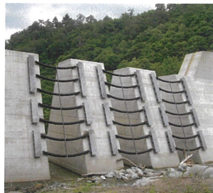
弾性チェーン式土石流・流木捕捉工
