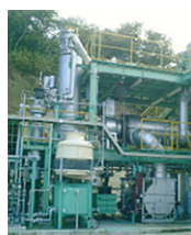
▲バイオマス熱分解発電装置
