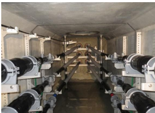
洞道内ケーブル
