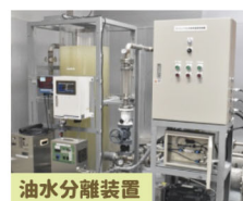
油水分離装置
