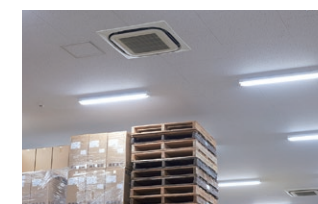
品質と快適な環境を守る空調設備
