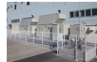
電力を安定供給する非常用発電機
