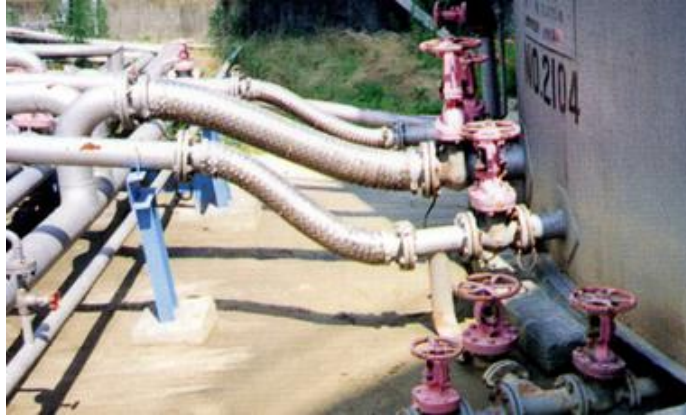
タンクの沈下600mm、ベローズ形可撓管継手に漏れはない
