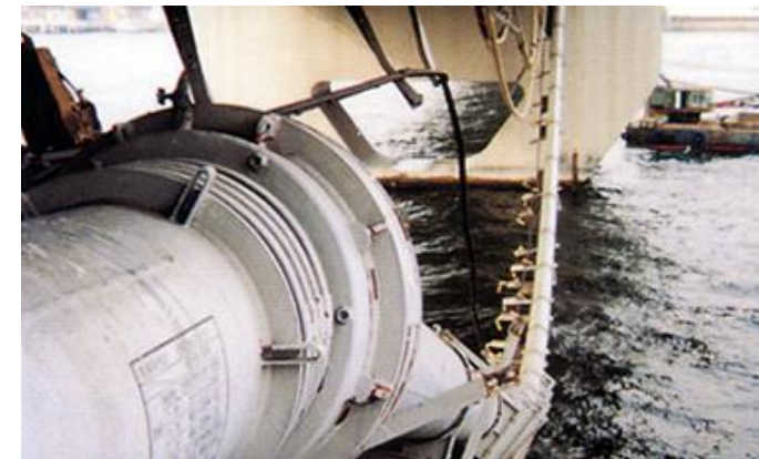
六甲大橋落下した水道管(700A) 異常に変位した伸縮管、これでも漏れはない
