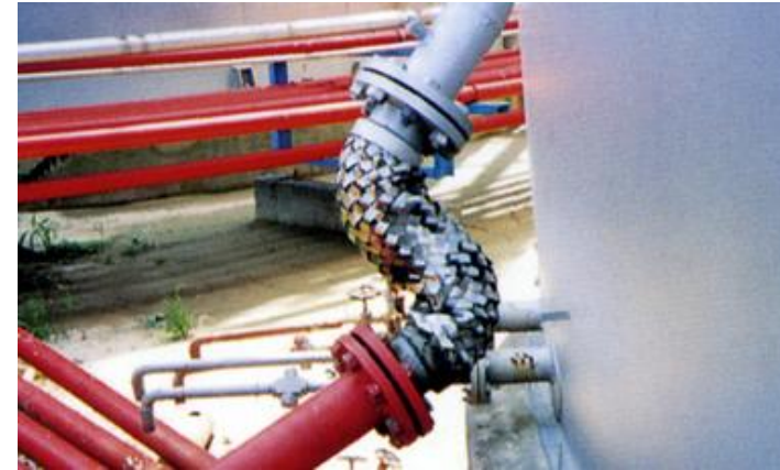
石油タンクに取り付けられたベローズ形可撓管 これ程曲がっても漏れはない
