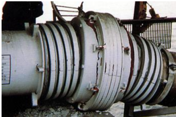
六甲大橋水道管が落下、伸縮管は著しく変形したが漏れはない
