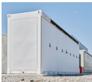
大型蓄電システム(夜間稼働用)
