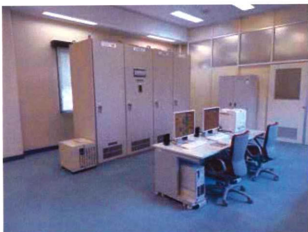
監視・コントロール設備
